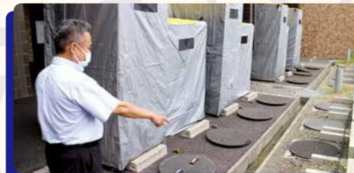
トイレに変身するグラウンドのマンホール
