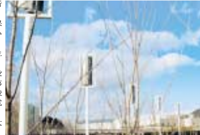
風力発電設備(凜風館屋上)
